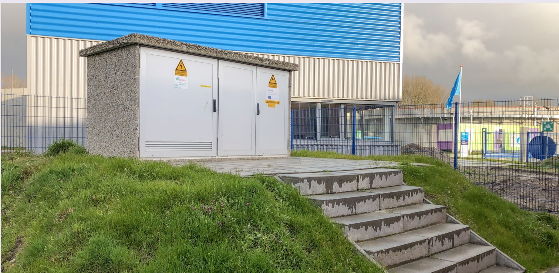
De rioolwaterzuiveringsinstallatie in Weesp was aan vervanging toe. De beheerder ging zelf aan de slag en maakte de installatie direct klimaatbestendig. Foto: Rob Koeze
